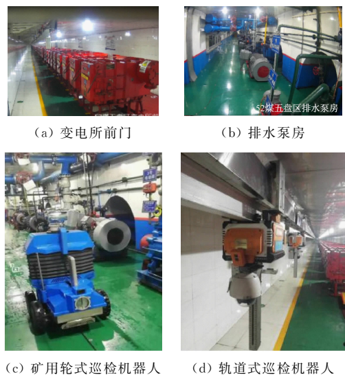
图 4 改造后的五盘区变电所及水泵房现场
