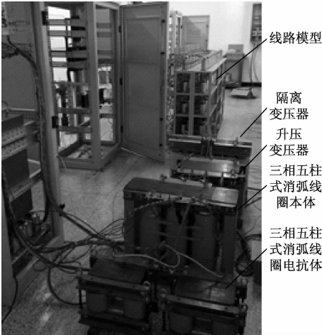
图 5 660 V 低压实验平台实物
